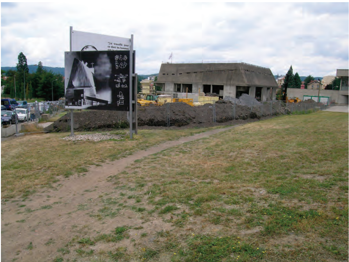
État de l'église en attente de reprise, vue extérieur. Photo Jean-Marc Dufix pour Aline Duverger, architecte.
